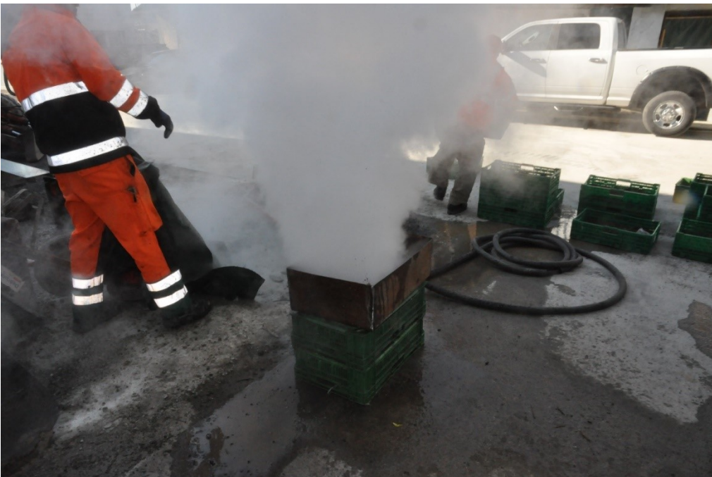
Bild 2: Entsprechend dem geplanten Gerät wird die Felderde von unten mit Dampf behandelt.
