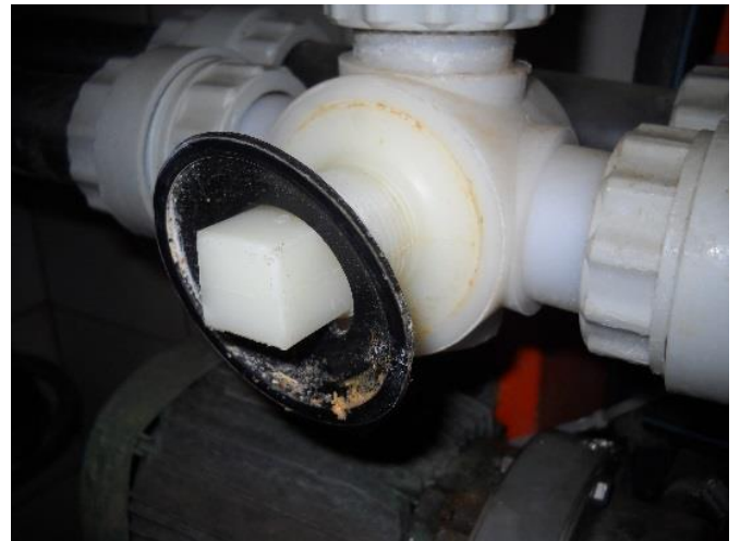
Fig. 7: Dépôts dans une vanne trois voies
