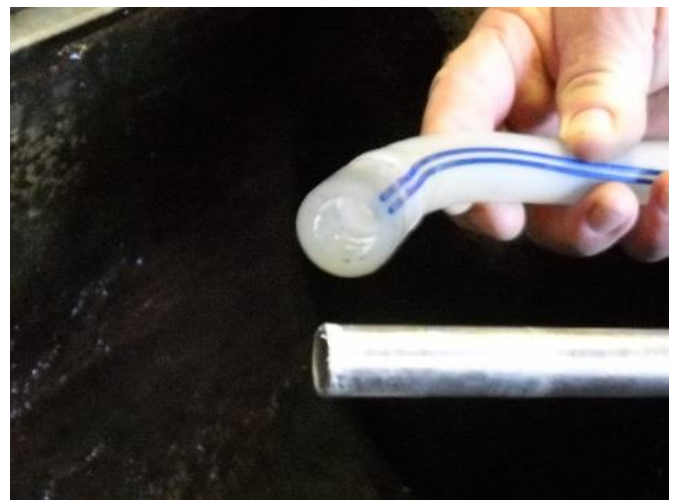
Fig. 8: Dépôts dans un raccord de tuyau
