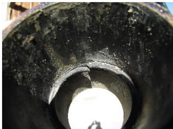
Fig. 10: Joint défectueux d'une conduite à lait
