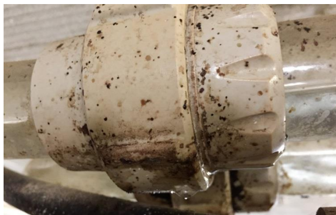
Abb. 13: Tropfende Melkleitung mit defekter Dichtung
