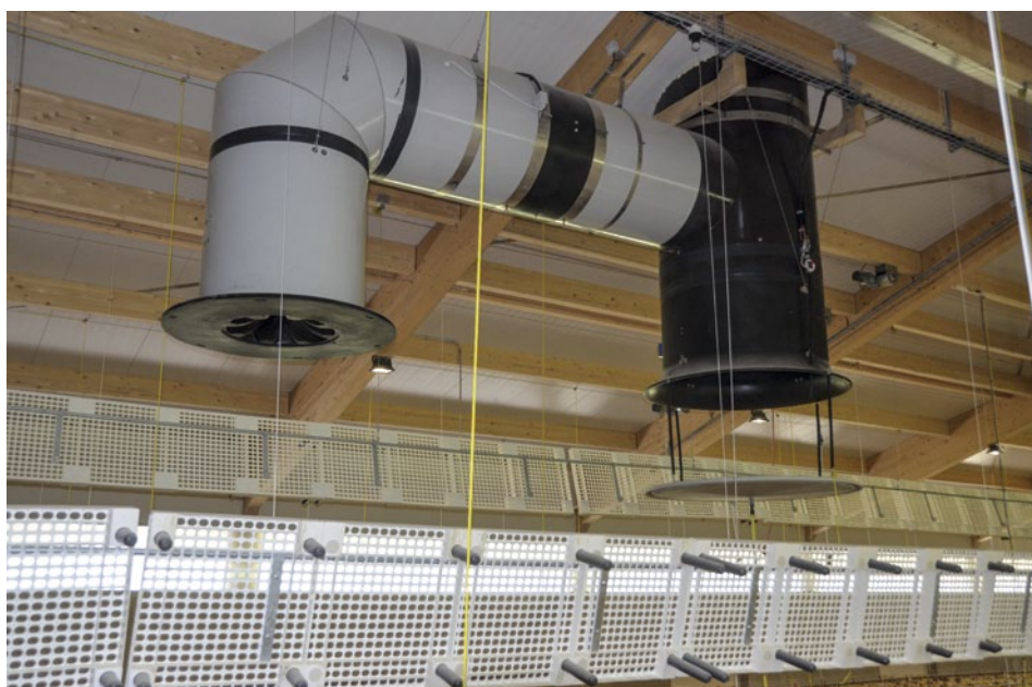
Abb. 3 | Wärmetauscher im Geflügelstall.
