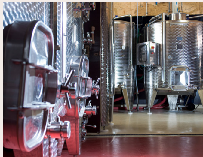
In Trauben eingelagerter Stickstoff sorgt dafür, dass im Keller die Gärung weitgehend problemlos erfolgt. (© weinweltfoto)
