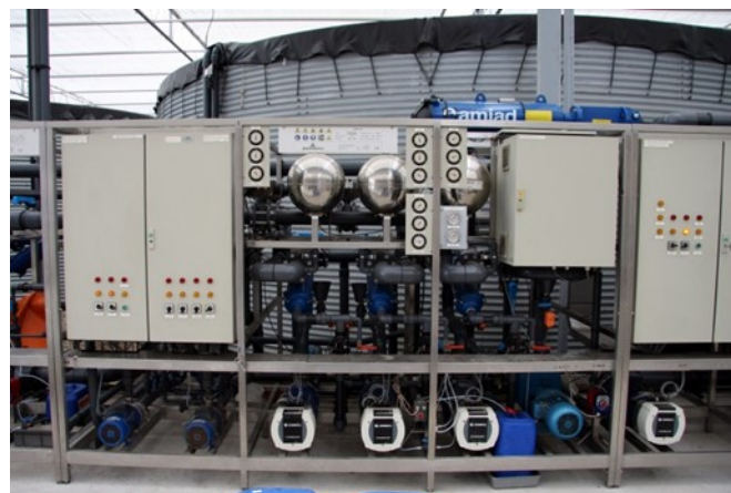
Figure 7. Système de désinfection de l'eau aux UV. (Photo : V. Günther)
