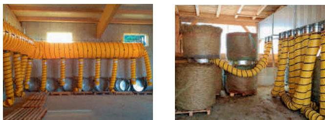
Abb. 12: Links Belüftung mit flexiblen Schläuchen und Zwischenringen; rechts Blechkanal kombiniert mit flexiblen Schläuchen.
