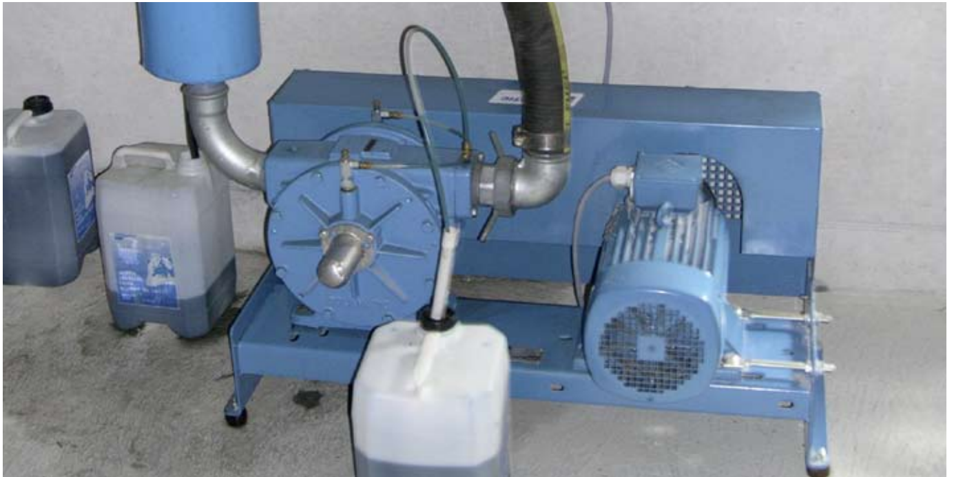
Le montage de la pompe à vide sur des supports élastiques adaptés à son poids et des raccords souples de l'échappement et de la conduite principale évitent la propagation des vibrations. (Rapport FAT 625)
