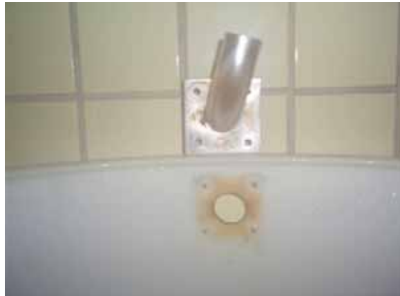
Abb. 7: Demontierter Stutzen mit Biofilm
