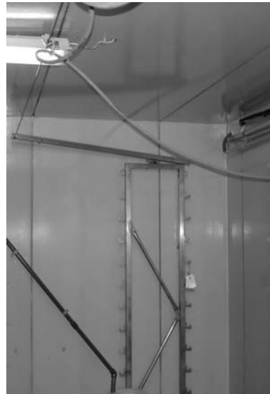
Abb. 5: gutes Beispiel einer Aufhängung ohne Deckebohrung
